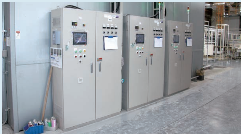
▲ ハイブリッド連続乾燥炉の制御盤
