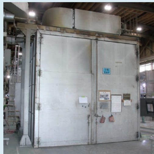
▲ 水切り乾燥炉用のバッチ炉
