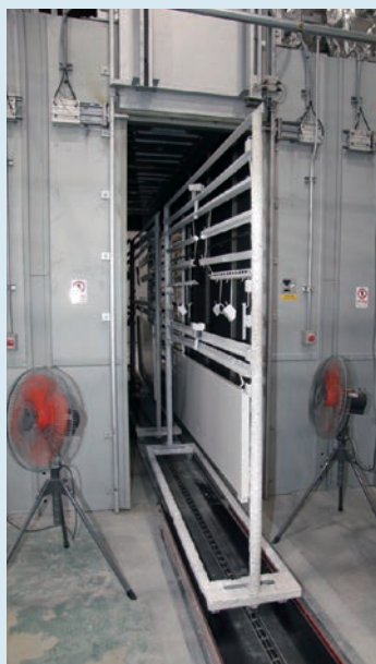
▲ 乾燥炉出口側
