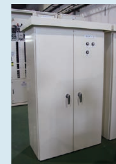
▲ 完成した配電盤
