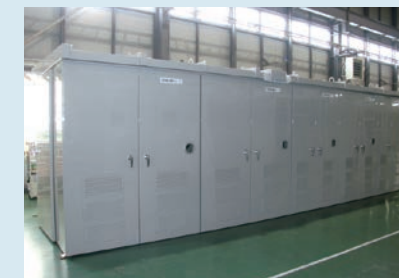
▲ 完成した大型キュービクル設備
